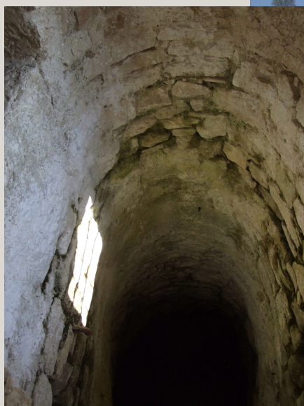
Fossalto – Pozzo con casetta. Interno.
