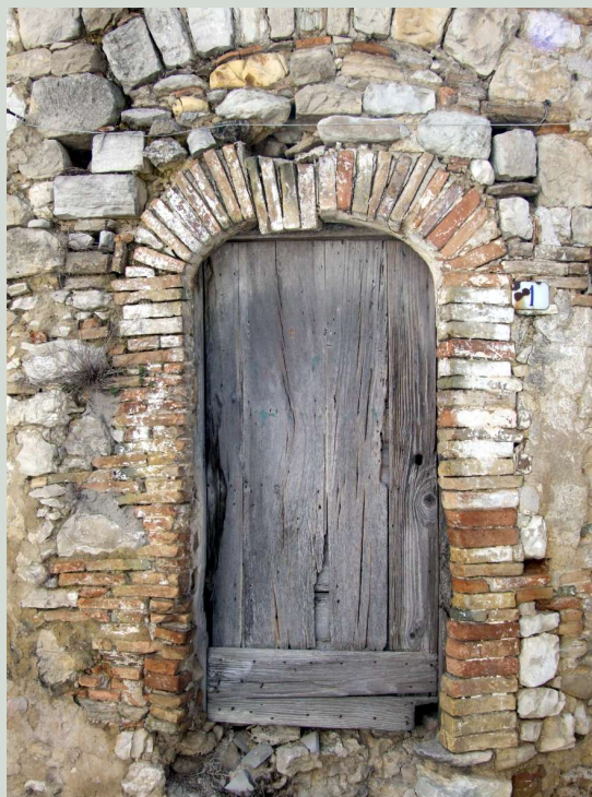
Palata - Particolare della porta di accesso. La sconnessione dell'arco del portale è dovuta a dissesti e cedimenti della struttura portante.
